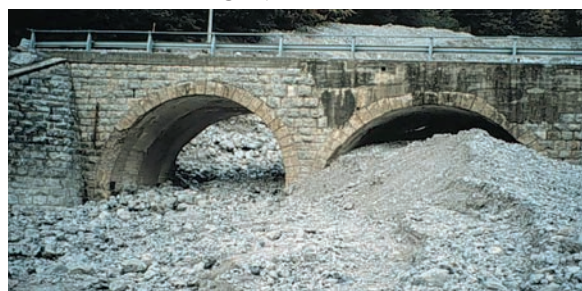
Fig. 1 - Colata detritica ( debris flow ) in un alveo torrentizio alpino, con ostruzione di una delle due luci del piccolo ponte.
